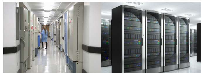
Solutions de secours pour palier les coupures électriques
